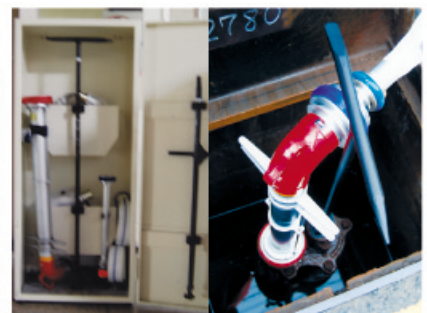
消火栓に取り付けたスタンドパイプと格納庫
